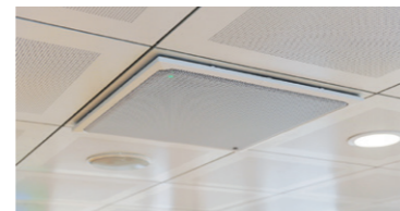
Microfono Ceiling Array RM-CGW installato sul soffitto della sala riunioni
